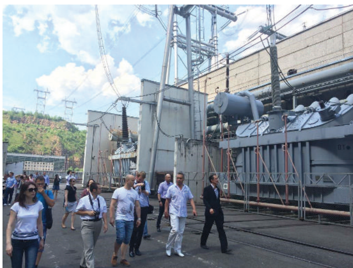
Besuch des Wasserkraftwerkes GES, Krasnojarsk
